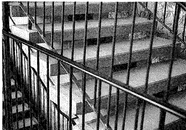
Die Geländerhöhe von 85 cm entspricht nicht der Mindestanforderung der DIN 58 125 von 1,00 m.
