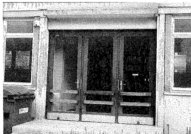
Die Außentüren aus Weichholzrahmen besitzen weder dauerhafte Beschläge noch die nach DIN 58 125 erforderliche Sicherheitsverglasung.
