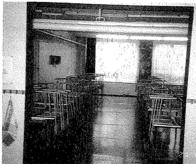
Abgehängte, unverkleidete Leitungen schränken die Nutzung des Kellergeschosses ein.
