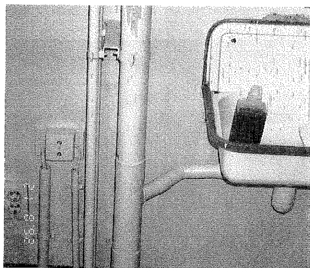
Auf der Wand verlegte Installationen sind offensichtlich Gefahrenquellen
