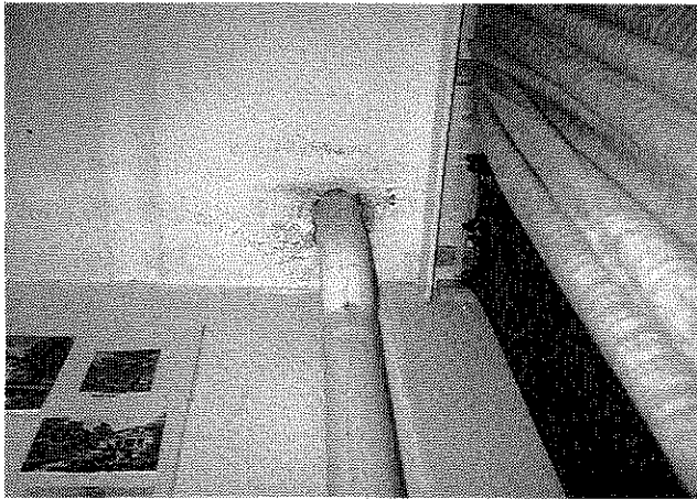
Durchfeuchtungen im Bereich der Entwässerungsröhre
