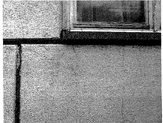
Schäden an den Gasbetonbrüstungsplatten
